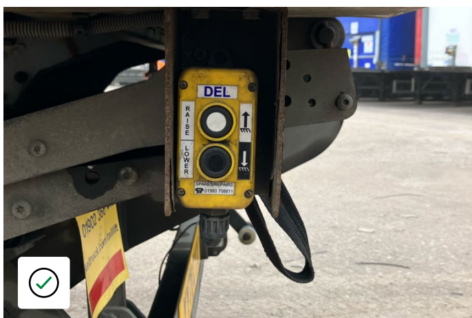
Laadliftbediening aanwezig en operationeel
