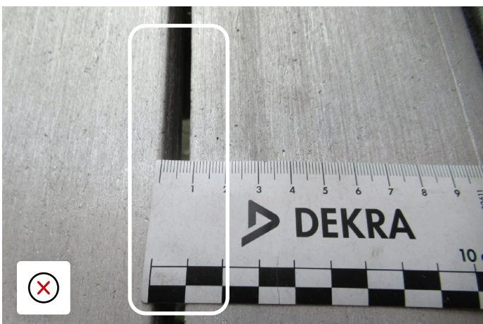
Teveel ruimte tussen de vloerbalken en niet veilig voor transport - goederen kunnen door de vloer vallen.
