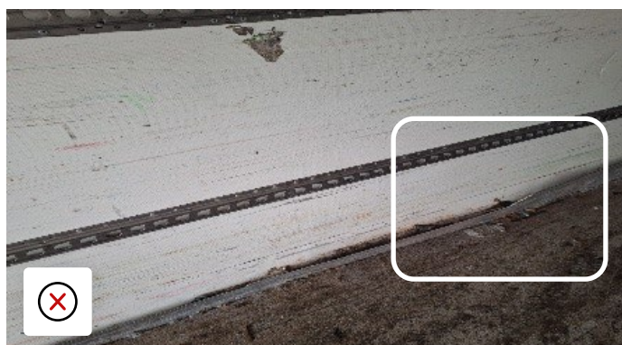
Stootstrip is beschadigd en losgeraakt van paneel.
