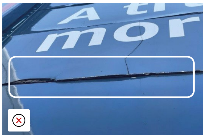
Deurpaneel op roldeur gebarsten door impact
