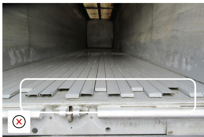
Eindstukken vloerbalken ontbreken - goederen kunnen tussen de vloer komen.
