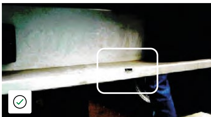
Stootschade die niet van negatieve invloed is op de constructie en tegen geringe kosten kan worden schoongemaakt en gelakt.
