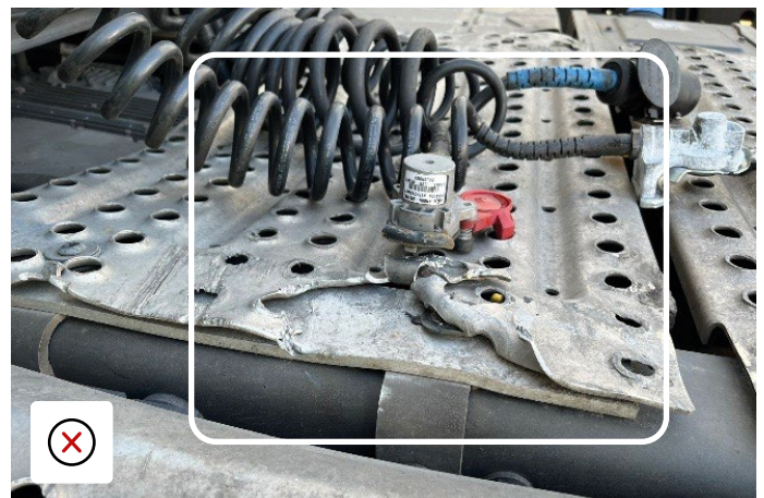
Vlonderplaat beschadigd waardoor struikelgevaar
