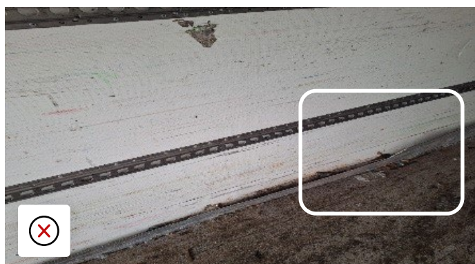
Okopový plech poškozený a odlepený od panelu.
