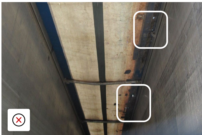
Díry v krytu - vyžaduje opravu
