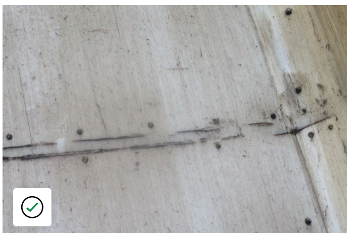
Ochrana podlahy s drobnými oděrkami - přiměřené opotřebení
