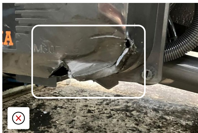
Rozbitý kryt - vyžaduje výměnu
