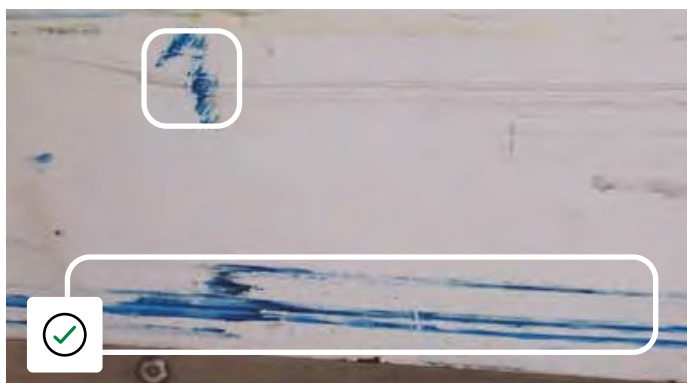
Panel z GRP sklolaminátu poškrábáný paletami, ale gelcoat není proražen.
