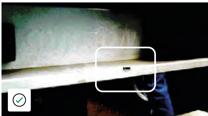
Poškození nárazem, které nenarušuje provoz a lze bez větších nákladů vyčistit a natřít.
