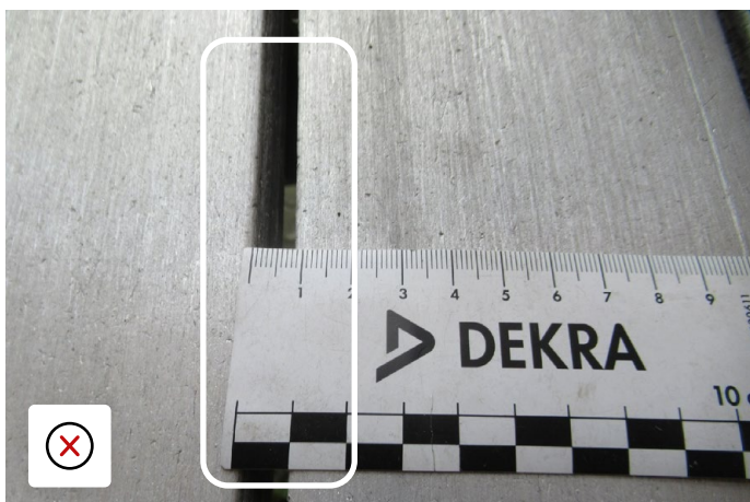
Podlahové tyče jsou roztažené a nejsou bezpečné pro přepravu - zboží může propadnout podlahou
