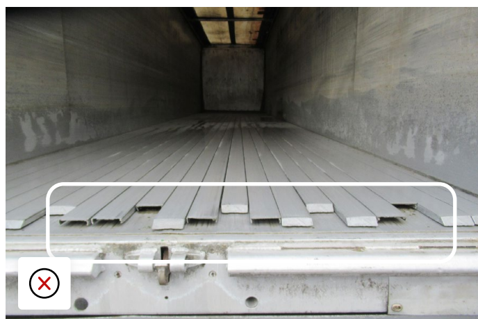
Chybí okraje tyčí - zboží může zapadnout pod podlahu
