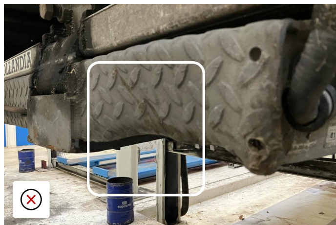
Platforma uderzona w ważnym miejscu - wymaga naprawy
