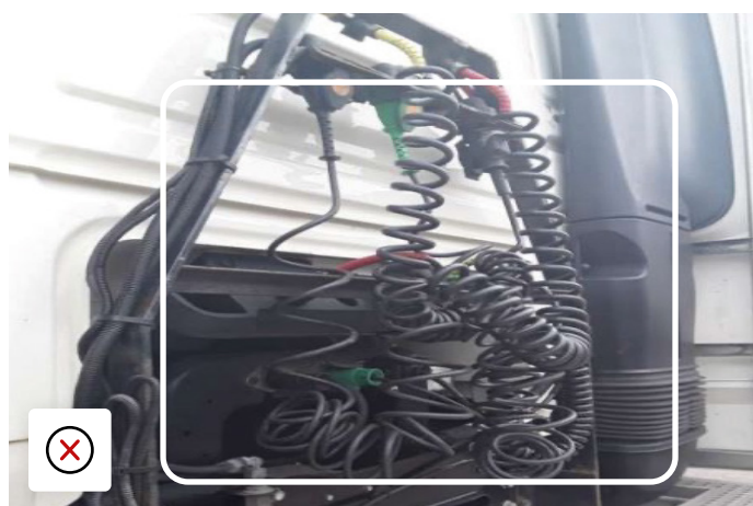
Przewody przyłączeniowe rozciągnięte z powodu niewłaściwego użytkowania
