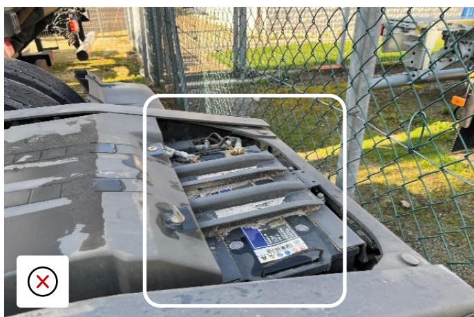
Brak pokrywy akumulatora - narażenie akumulatora na działanie czynników atmosferycznych
