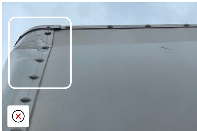
Słupek narożny uszkodzony w wyniku uderzenia ze zdartą farbą.
