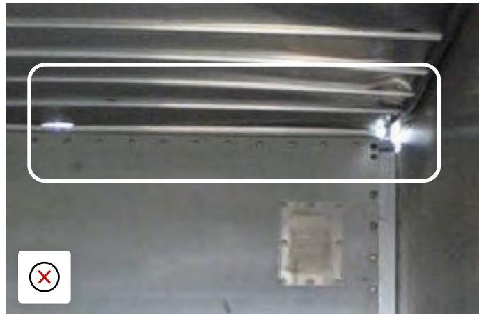
Uszkodzenie przedniej blachy dachowej
