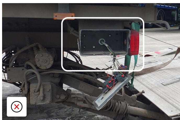
Uszkodzony przełącznik zewnętrzny - wymaga wymiany
