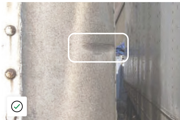
Słupek narożny uszkodzony w wyniku uderzenia, wgnieciony, ale nie podziurawiony.
