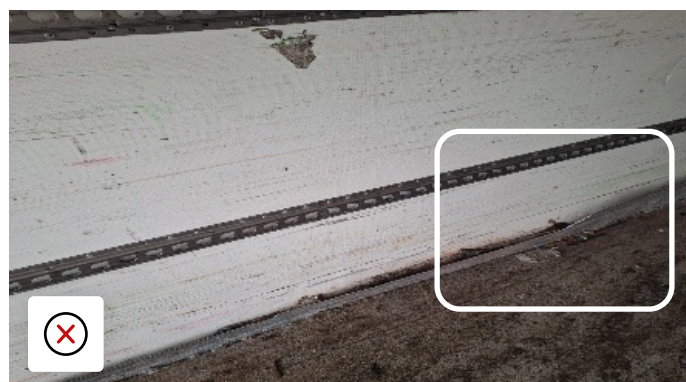
Uszkodzona i oderwana od panelu listwa progowa.
