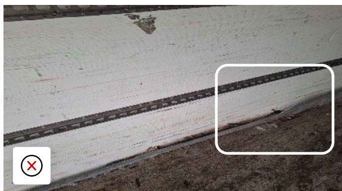
Bandă de protecție deteriorată și desprinsă de panou.
