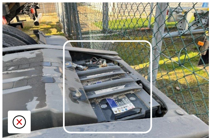
Capacul bateriei lipsește - bateria este expusă la intemperii
