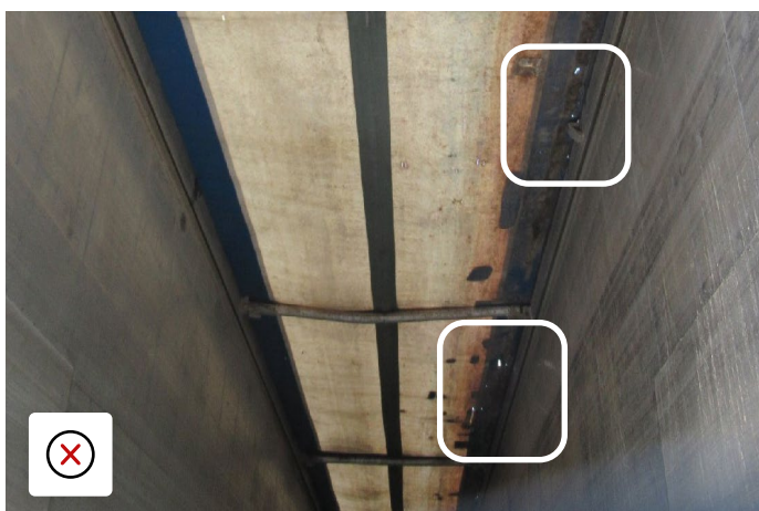
Găuri în capac - necesită reparații
