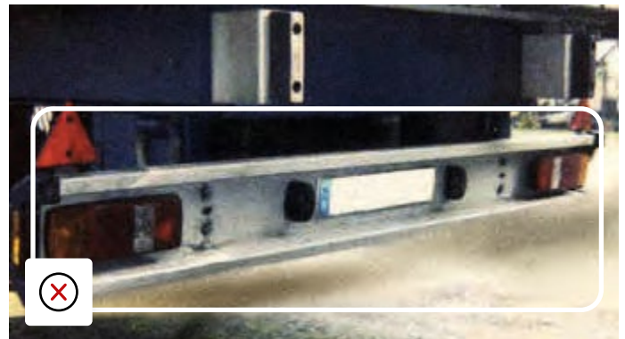
Garda de sub rulare îndoită și necesită reparații
